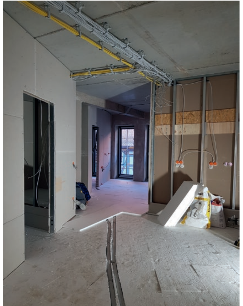
Vor der Verlegung des Estrichs im zweiten Obergeschoss am 17. Januar baute die Firma Rüttger in der gesamten Ebene die Dämmlagen ein.
