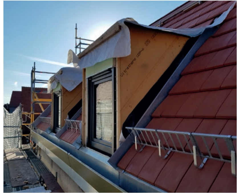
Die Dachdeckungs- und Spenglerarbeiten der Fa. Kaidel sind schon sehr weit fortgeschritten. Die Eindichtung der Dachgauben und der Flachdächer steht in Kürze an.
